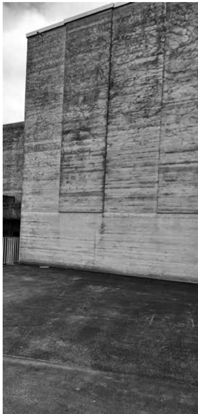
Leere Betonwand und versiegelter Boden beim Schulhausareal: missachtete Biodiversität (Foto: Madeleine Thönen)
