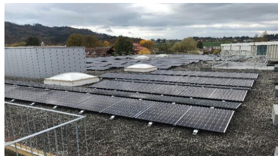
Photovoltaik Anlage auf Gewerbeliegenschaft
