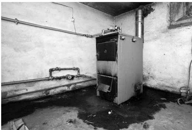
So nicht. Alte Heizungen sind Gift für die Umwelt
