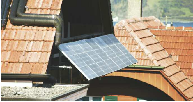
Solaranlage an Fassade
